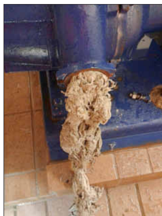
Viele Feuchttücher verursachen solche Verzopfungen, die häufig zu Betriebsstörungen in den Anlagen des Abwasserzweckverbandes führen.
