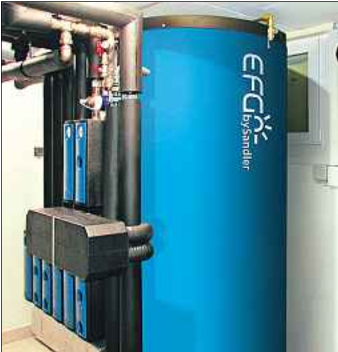
Äußerst effizientes Speichersystem: Ein moderner Wasserspeicher kann im täglichen Gebrauch bis zu 70 Prozent der im Haus benötigten Energie einsparen Bild: EFG/interPress
